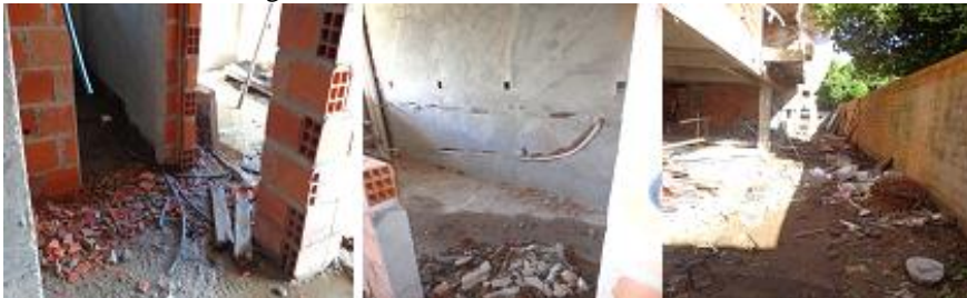
Figura 3 – Descarte incorreto de materiais
