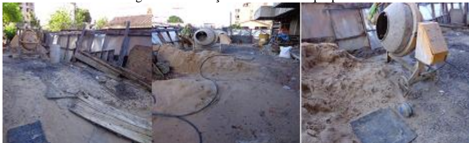
Figura 4 – Alocação de material imprópria
