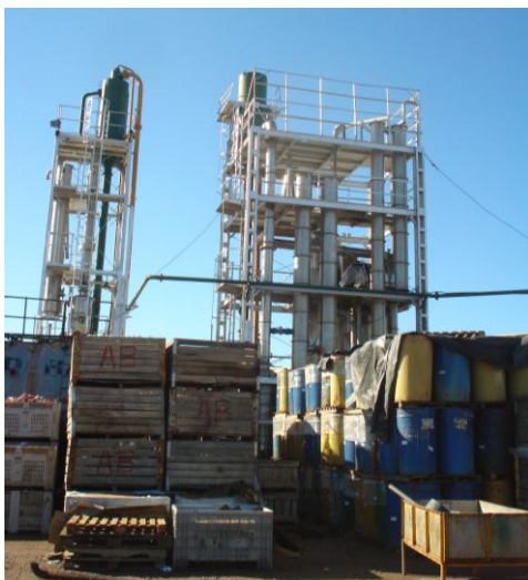
Figura 1: Vista del conjunto de concentradores
