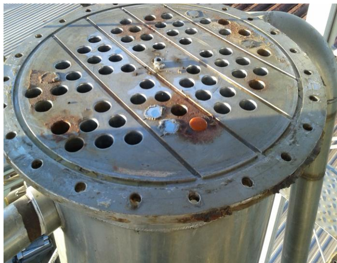
Figura 2: Estado de intercambiadores de calor
